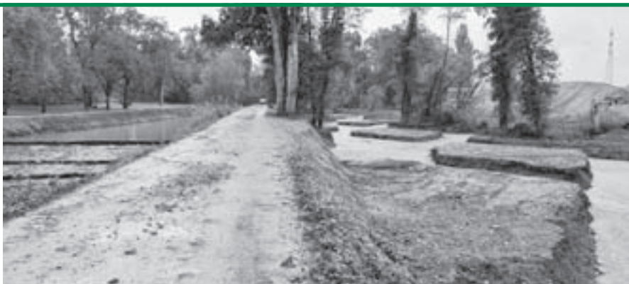
L'Aire avec ses nouveaux losanges, la digue au centre sera abaissée et "coupée" par des sillons permettant aux eaux de s'écouler librement dans l'espace du canal et des losanges. Photo du 4 octobre 2021
